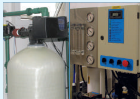
• Ablandadores automáticos • Osmosis inversa
